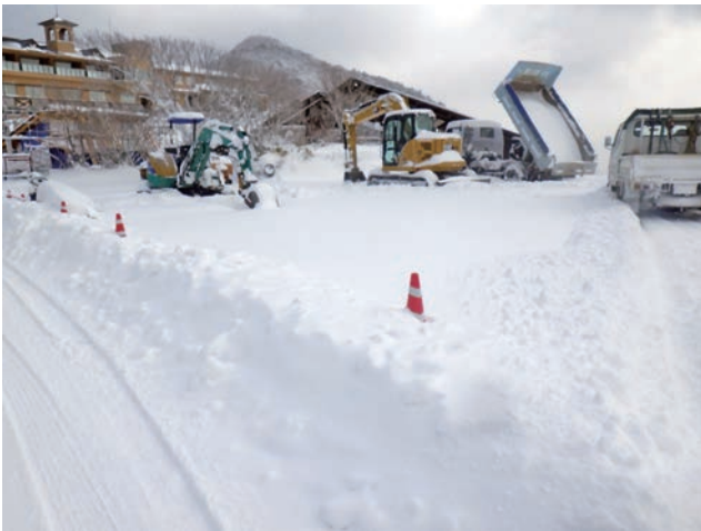
写真-8 現場の積雪状況
