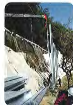
↑この支柱が垂直に立たなくなる 上の基礎工をちゃんとしないと 壁面パネルの為の支柱建柱
