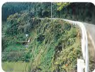
下の田んぼと路側急斜面落差12m
